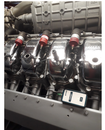
Compri Gerät installiert auf einem Kraftwerk MTU4000 (Powertec 1160) Gasmotor
